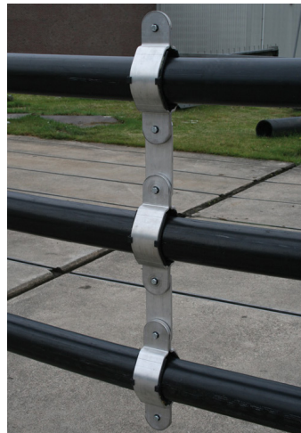
INSTALACIÓN TÍPICA. FOTO OBTENIDA EN UN EVENTO DE PRUEBAS DE CORTOCIRCUITOS EN KEMA LAB, ARNHEM, NL.
