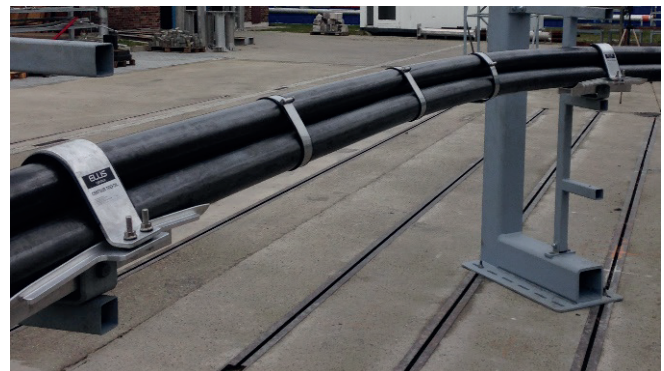
EIN FOTO DES KURZSCHLUSSPRÜFSTANDES FÜR CENTAUR DREIPASS. DIE TESTS WURDEN IN DEN ZKU-LABORATORIEN IN PRAG, CZ, DURCHFÜHRT.
